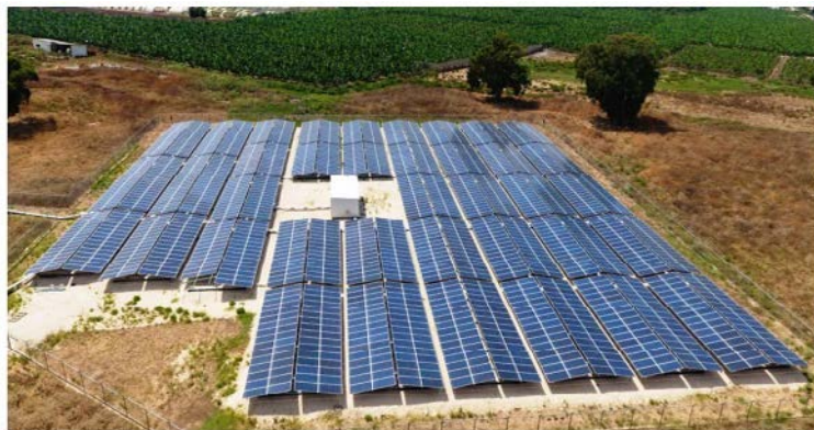
Figura 14 – Visão aérea da planta FV em Zahrani, Líbano.
