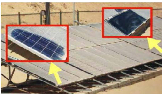
Figura 7 – Acúmulo de sujeira em módulos FV instalados no Egito.
