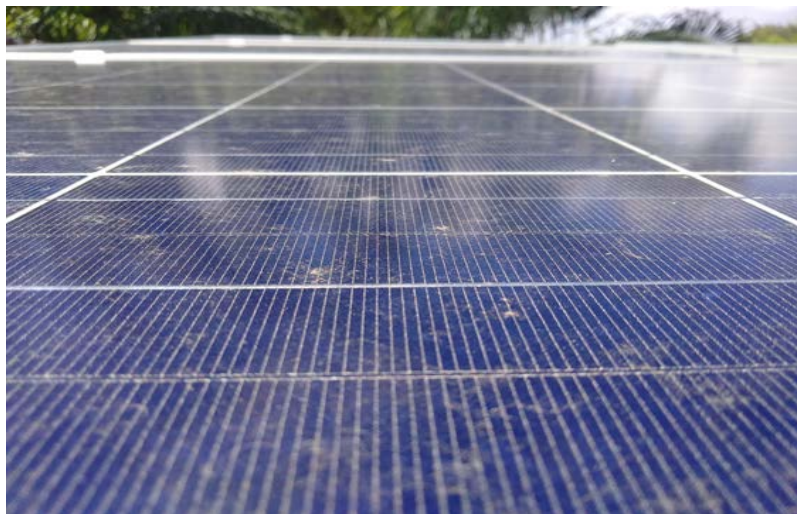
Figura 5 - Sujidade encontrada nos painéis FV
