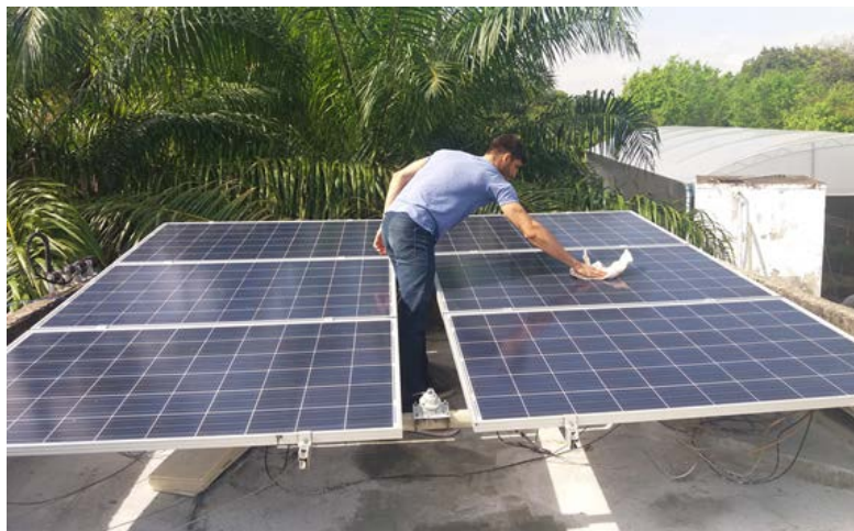
Figura 6 – Limpeza dos módulos FV para evitar não-idealidades
