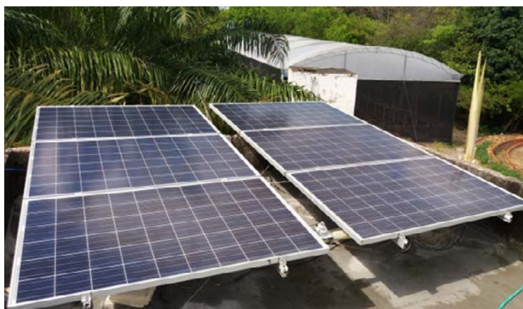
Figura 4 – Planta da microgeração FV instalada no LEA-UFC e conectada à rede do campus do Pici
