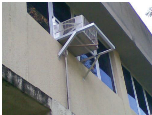
Figura 05: Tubulação conectada ao aparelho direcionada ao solo.
