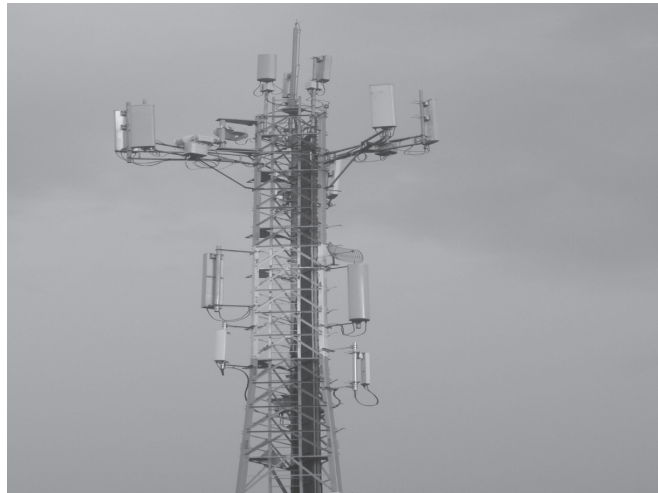
Figura 1: Estação Rádio Base instalada na Cidade de Rio Branco
