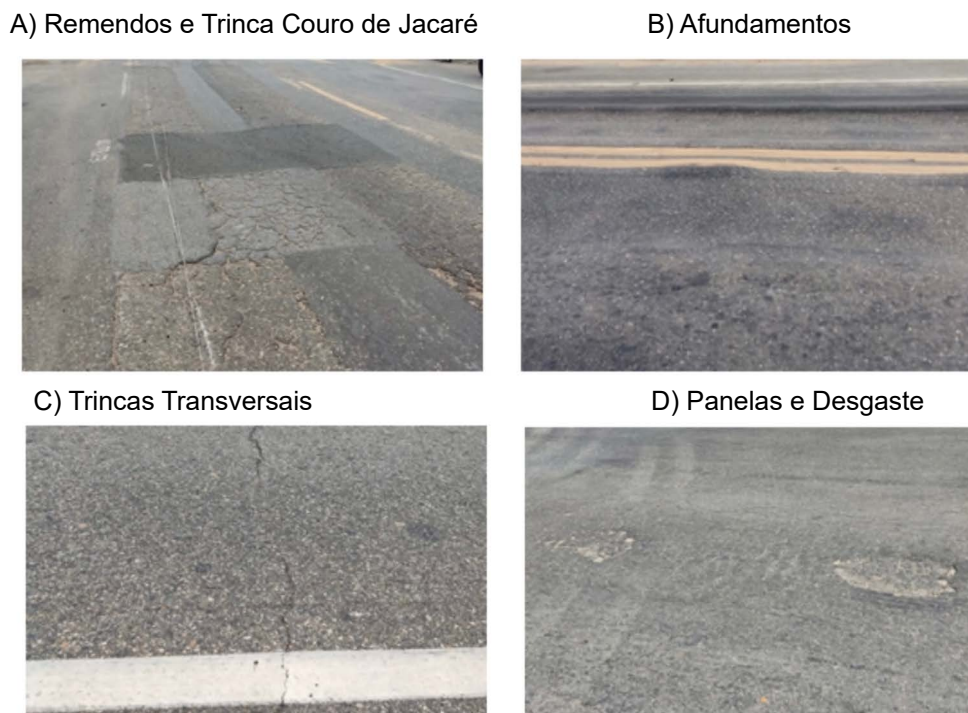
Figura 2 – Principais defeitos encontrados na Rodovia BR-222.
