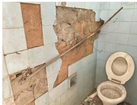
Figura 10 - Descolamento e deslocamento do revestimento cerâmico no banheiro.
