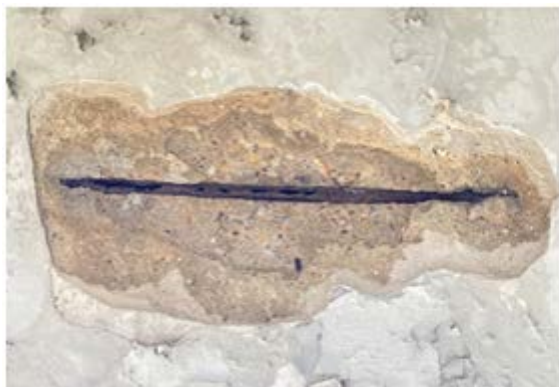
Figura 7 – Desagregação do concreto por oxidação da armadura.
