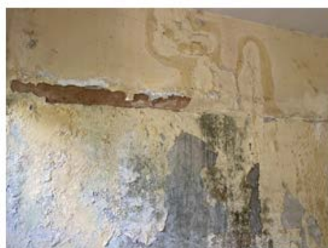
Figura 4 – Infiltração com presença de eflorescência.
