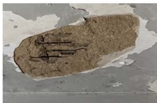
Figura 6 – Falta do cobrimento mínimo necessário em laje.
