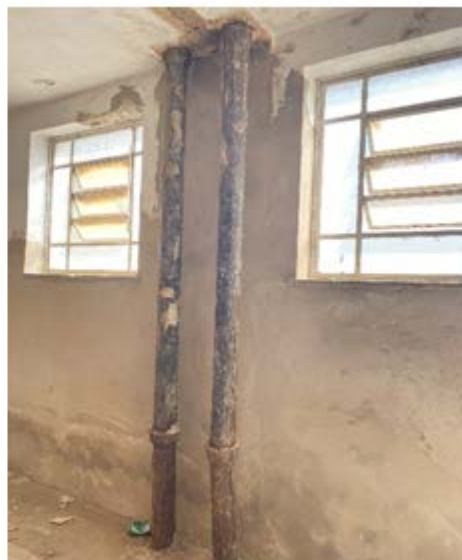
Figura 12 – Corrosão em tubulação de incêndio no primeiro pavimento.
