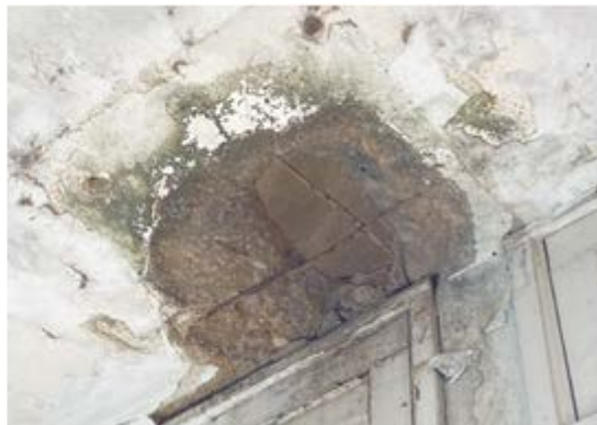
Figura 8 – Corrosão em malha de ferro, em laje.
