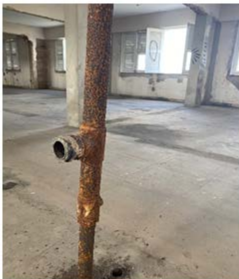
Figura 11 – Corrosão em tubulação de incêndio no segundo pavimento
