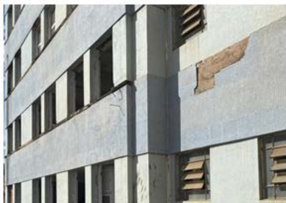
Figura 9 – Descolamento e deslocamento do revestimento cerâmico na fachada.
