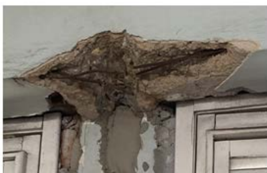
Figura 5 – Armadura de viga exposta e com rompimento.
