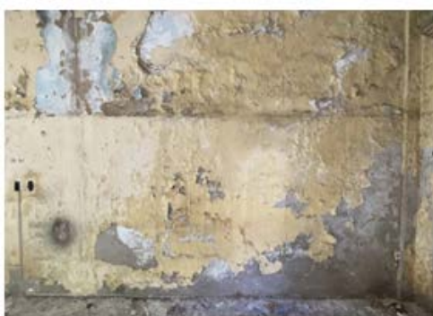
Figura 3 – Infiltração com deslocamento do revestimento.
