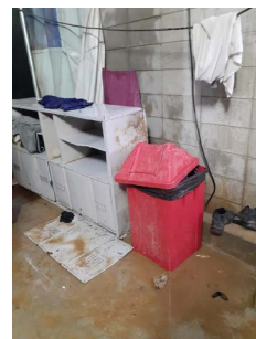
Figura 26 – Vestiário em péssimas condições
