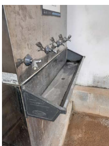
Figura 28 – Bebedouro em péssimo estado de limpeza
