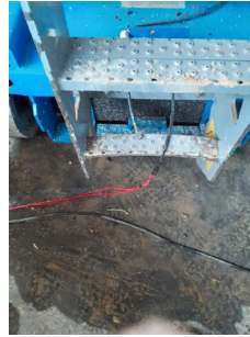
Figura 14 – Plataforma com cabos desprotegidos
