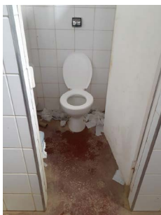
Figura 25 – Cabine de vaso sanitário sem limpeza
