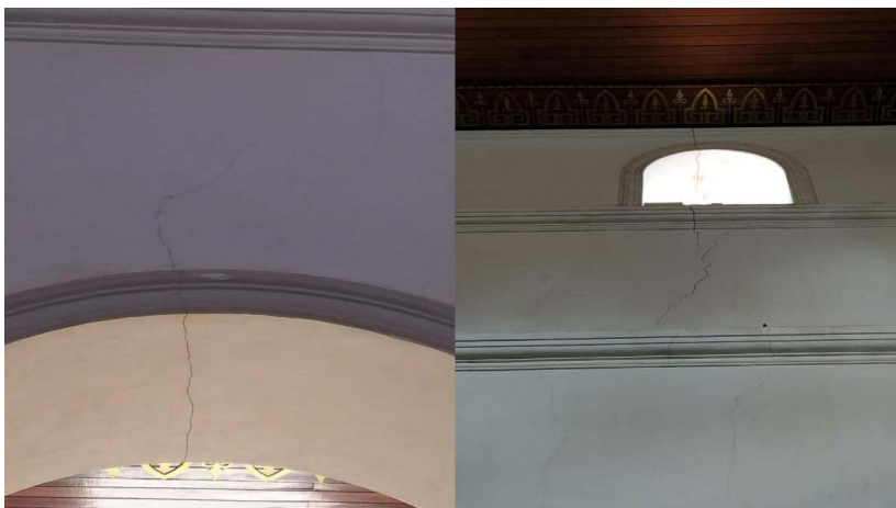
Figura 5 – Arco e óculo fissurados.
