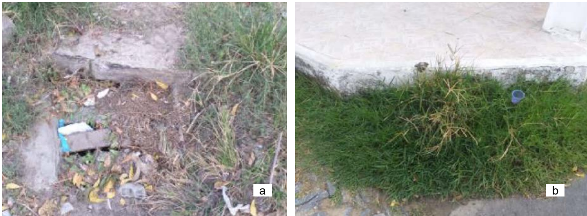
Figura 10 - Bocas de lobo obstruídas devido ao crescimento da vegetação no entorno. Em (a) boca de lobo B15 e em (b) boca de lobo B9.
