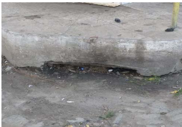
Figura 9 - Boca de lobo B3 entupida por resíduos sólidos (lixo)
