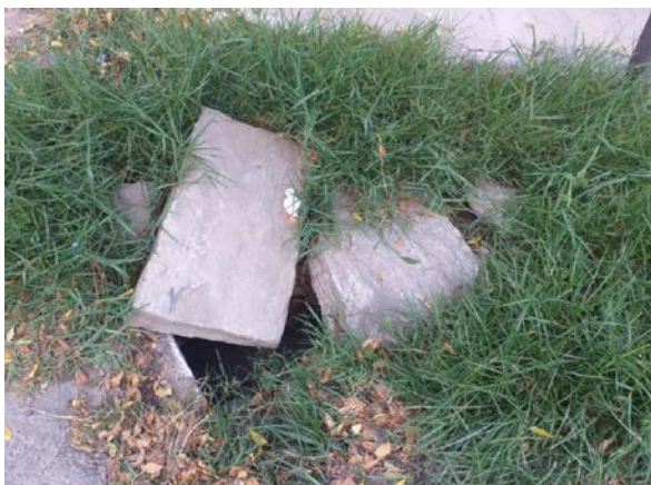
Figura 8- Boca de lobo B8 apresentando erosões.
