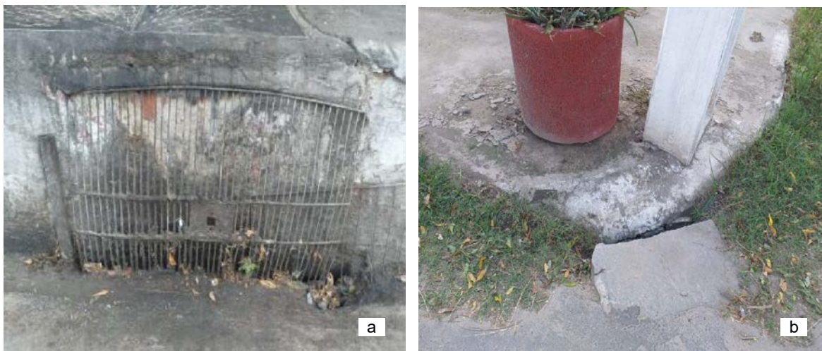
Figura 11 - Bocas de lobo com problemas de obstrução devido à pavimentação e do passeio. Em (a) boca de lobo B11 e em (b) boca de lobo B12
