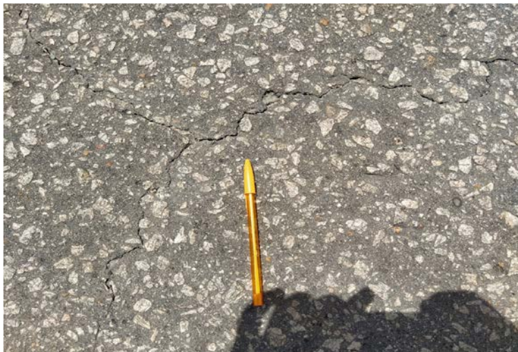
Figura 8 – Trinca e desgastes da superfície da via estudada
