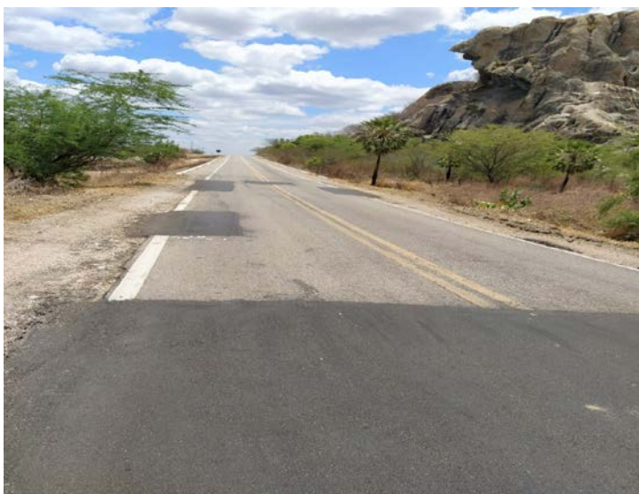
Figura 9 – Remendos encontrados no pavimento inspecionado
