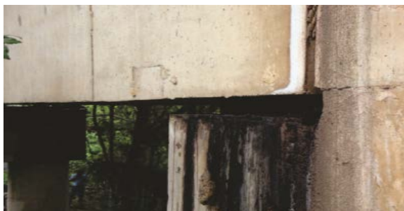
Figura 2 – Aparelho de apoio fretado de neoprene situado no encontro E1.
