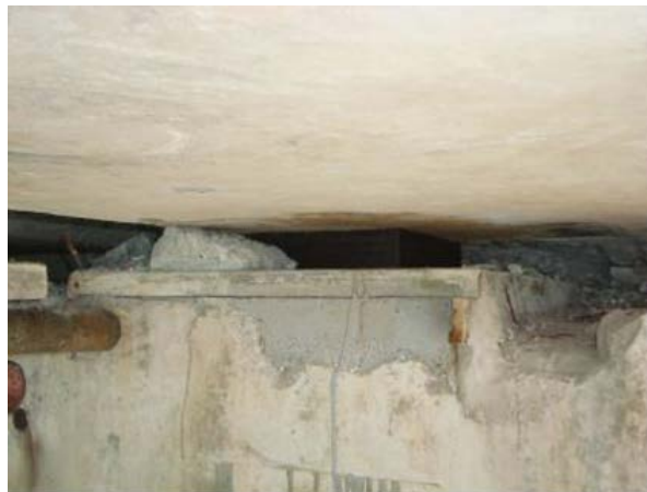
Figura 15 – Detritos de concreto.
