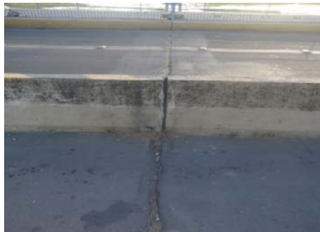
Figura 21 – Falhas na junta de dilatação.
