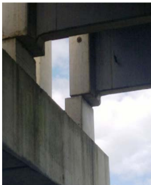
Figura 19 – “Rastejamento” da estrutura.
