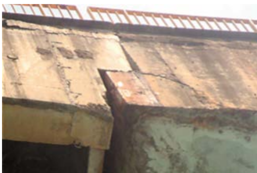
Figura 17 – Fissura e deslocamento na extremidade do apoio.
