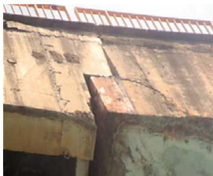
Figura 18 – Deslocamento na extremidade do apoio.
