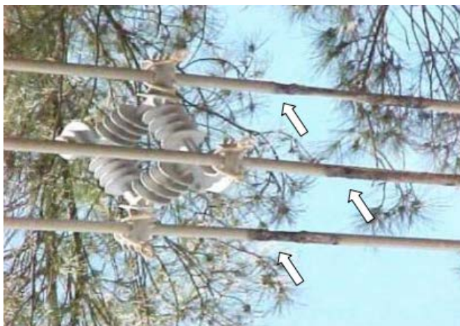
Figura 1 – Efeito da maresia nos cabos.
